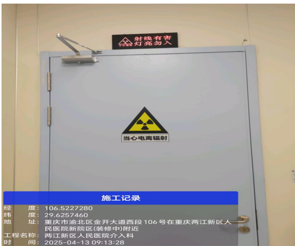
图 3-7 控制室防护门
